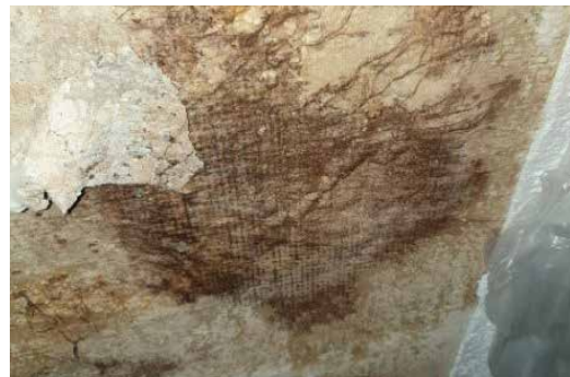
Abb. 4: Stränge und Myzel hinter Putz auf Mauerwerk
