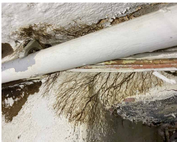
Abb. 1: Brauner Kellerschwamm. Wurzelartige Stränge am Mauerwerk und...
