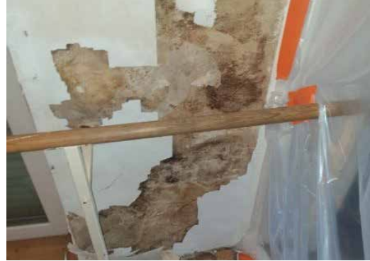
Abb. 3: Stränge und Myzel hinter Putz auf Mauerwerk
